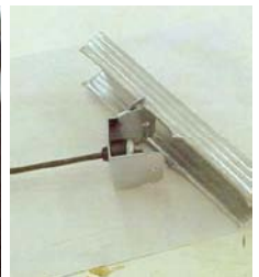
Modo de fallo. Rotura de las guías del perfil.
